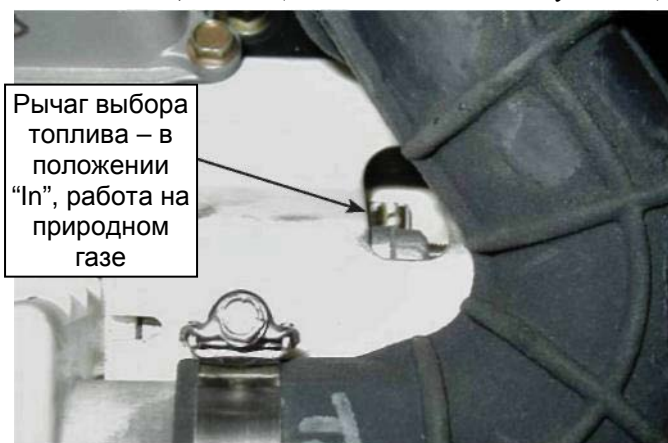
Рисунок 1.5 – 10кВт, GT-530 (Шланг подачи отодвинут назад)
